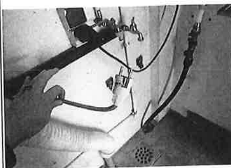
Foto 17: bijkomende opmerking Garage: stopcontacten gevoed via stekker in ander stopcontact
