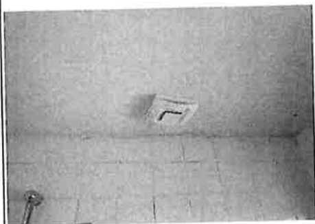
Foto 14: 51: indicatie van een risico op elektrocutie/brand Badkamer: afvoerventilator in beschermvolume
