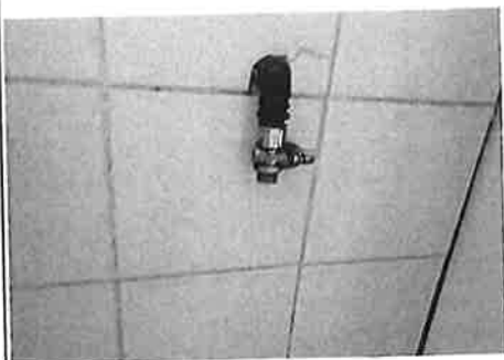
Foto 16: 61: indicatie van een risico op ontploffing/brand Keuken: open gasleiding
