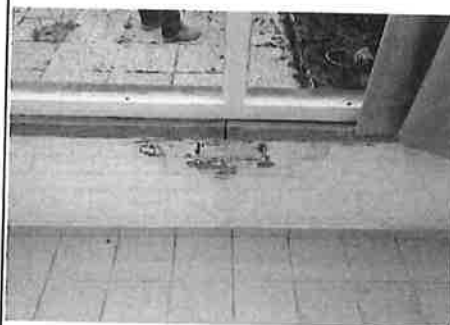
Foto 22: 111: opstijgend vocht / doorslaand vocht Veranda: vochtschade op achterste muur
