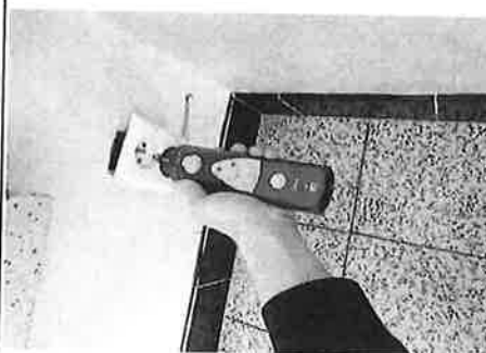
Foto 5: 51: indicatie van een risico op elektrocutie/brand Woonkamer: dubbel stopcontact in achterste muur met pen zonder aarding
