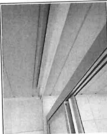
Foto 9: 51: indicatie van een risico op elektrocutie/brand Badkamer: lichtpunt in beschermvolume
