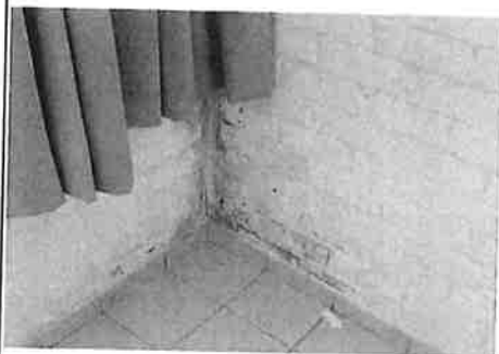
Foto 21: 111: opstijgend vocht / doorslaand vocht Veranda: vochtschade op achterste muur
