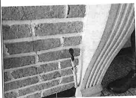
Foto 12: 61: indicatie van een risico op ontploffing/brand Woonkamer: open gasleiding zonder dop
