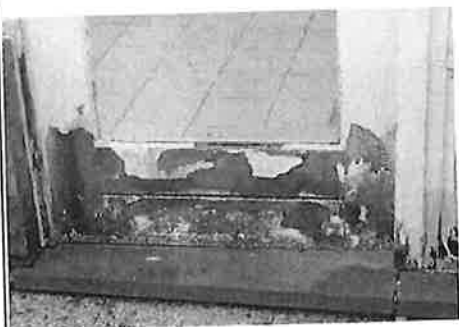
Foto 27: bijkomende opmerking Deur veranda: afbladderende afwerking
