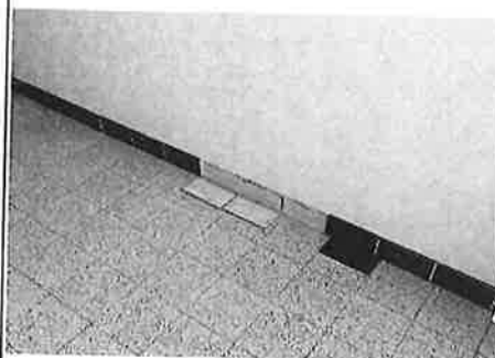
Foto 24: 132: beschadiging (excl. vochtschade) of verwerking / noodzakelijke afwerking ontbreekt Woonkamer: losse plinten aan rechtse muur
