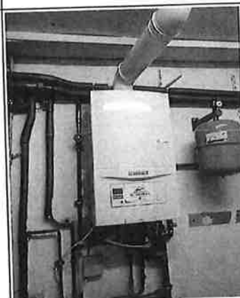
Foto 32: Verwarmingsketel type C
