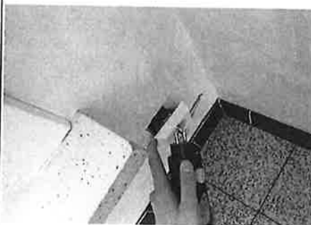
Foto 7: 51: indicatie van een risico op elektrocutie/brand Woonkamer: dubbel stopcontact in achterste muur hangt los
