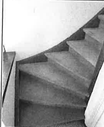
Foto 26: 171: trappen, overlopen, borstweringen met gebruiksonveilige elementen (te steil / gebreken ...) / trap naar een woonfunctie ontbreekt Trap 0-1: ontbrekende leuning onderaan de trap
