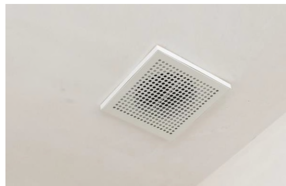
Afzuigingsrooster in plafond
