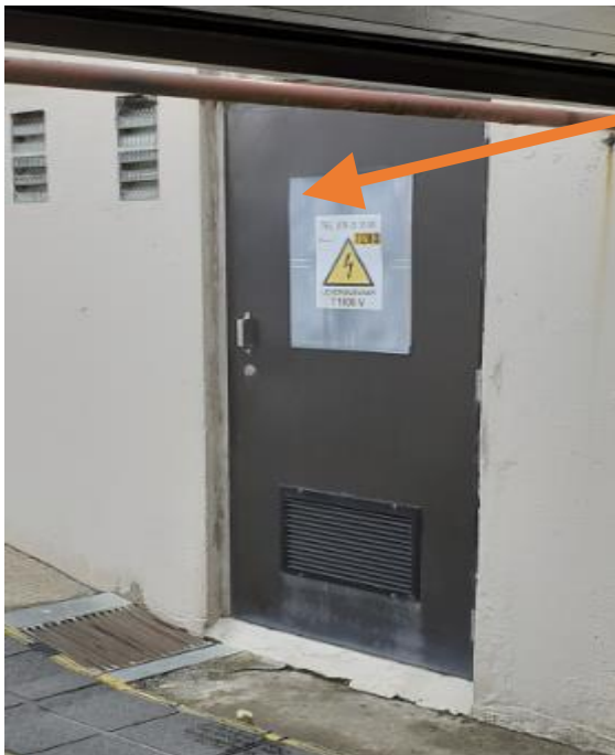
Figuur 10: Hoogspanningscabine, niet bezocht: mogelijk asbest aanwezig.
