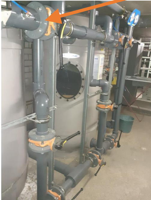
Figuur 5: Flenscoppeling in stookruimte: mogelijk asbesthoudend
