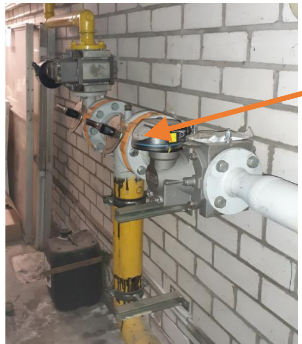
Figuur 11: Pakkingen in flens koppelingen: mogelijk asbest aanwezig.
