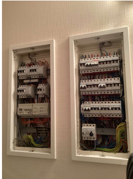
( Elektrisch bord - binnenkant )
