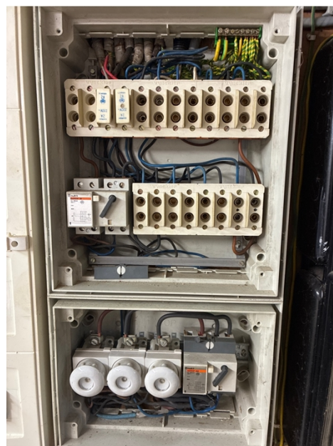
( Tableau électrique - intérieur )
