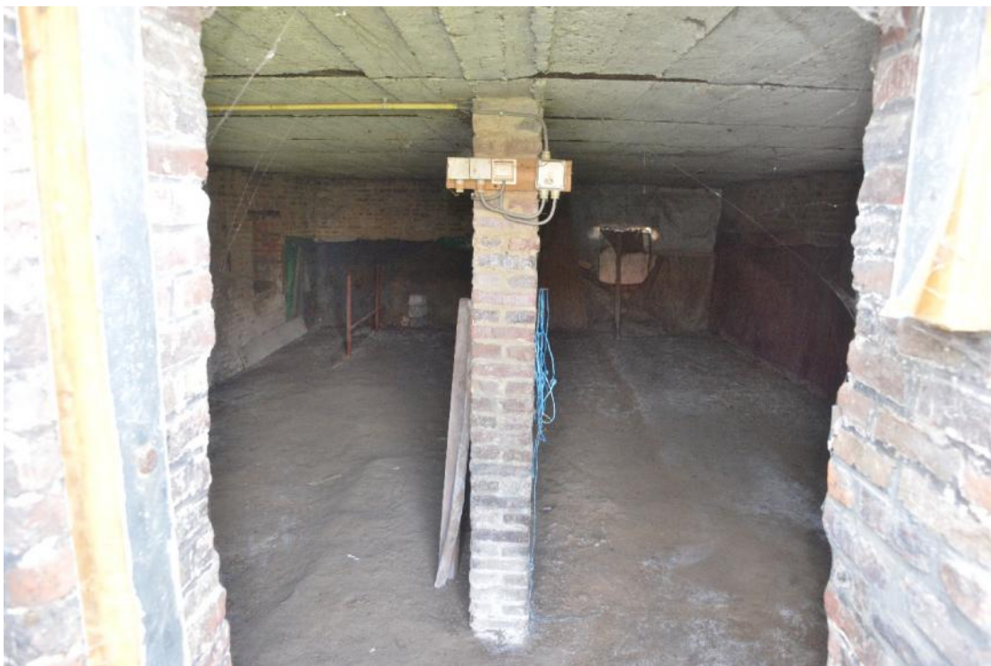
Binnenzicht: centrale muur t.h.v. brede buitendeur, geschilderde wanden, los latende verf. Roestige liggers tussen het beton.
