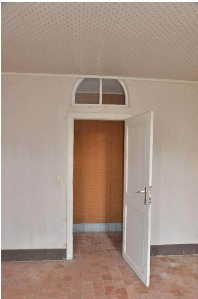
Oude toegangsdeur tot de kamer met halfroond bovenlicht, verstoord door het vals plafond. Het is ook hier aangewezen om alle verlaagde plafonds te verwijderen en de oude afwerkingen na te gaan.
