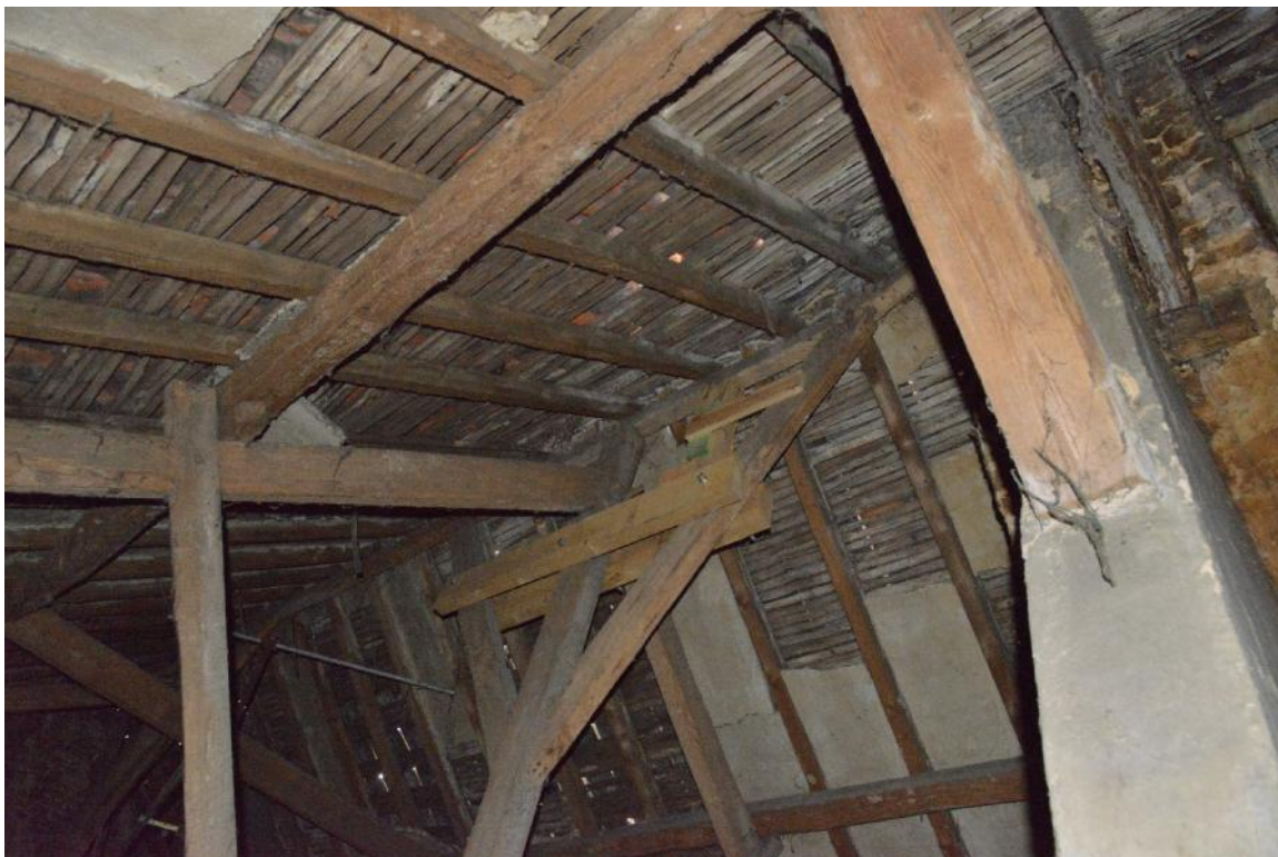
Zichtbare ingreep door gebrek aan de nokbalk.
