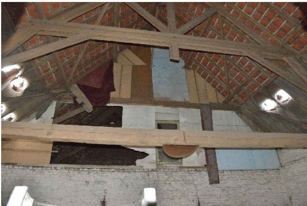
Aan de zuidzijde doorlopende kap boven tussenmuur. Spant afgedicht met divers plaatmateriaal.
