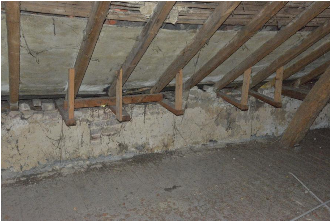
Zichtbare ingreep t.h.v. een gebrek aan de muurplaat.
